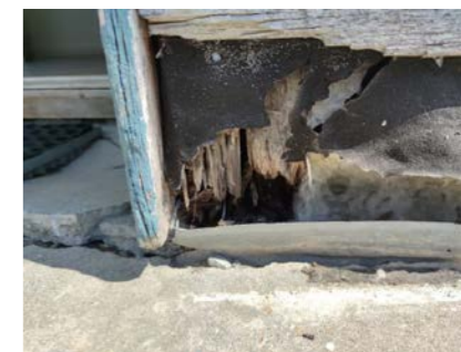
Råte i trekonstruksjon.
