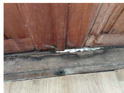
Råteskader i terrassedør.
