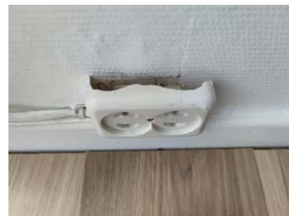
Skade på stikkontakt.
