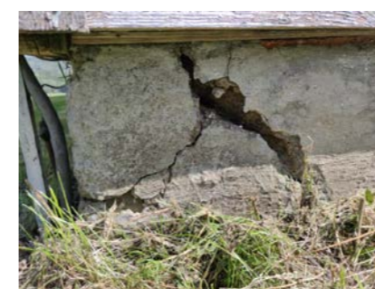
Sprekk i grunnmur mot nordvest.
