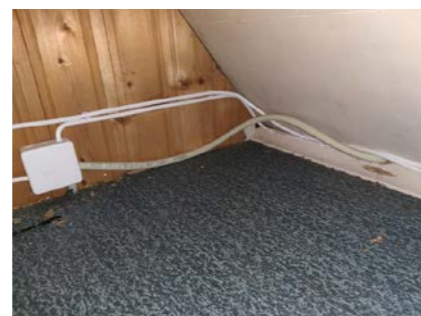
Kabel ikke festet tilstrekkelig.
