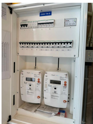
Sikringsskap for begge seksjonene er plassert i utvendig bod tilhørende seksjon 2.
