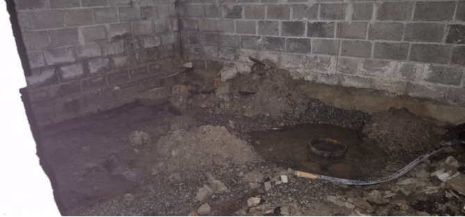
Rom med drenering og lensepumpe i kjelleren.
