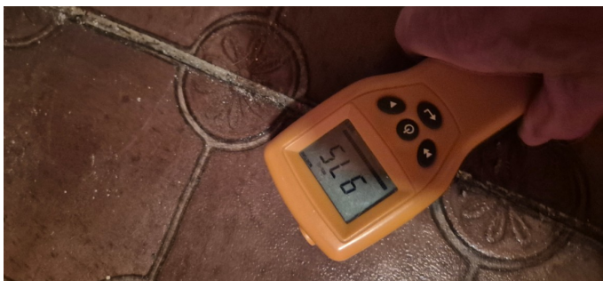
Fukt registrert i kjellergulv
