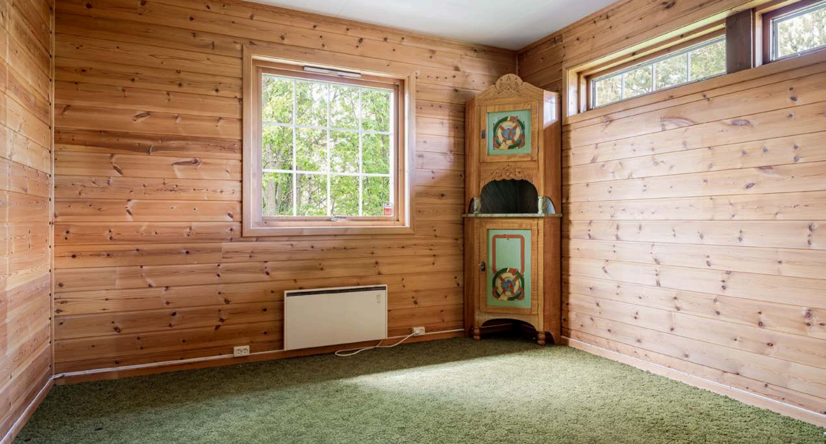
Soverom 4 var opprinnelig en garasje som ble ombygget i 1983. Det er ikke kjent med at det er søkt og bruksendring og rommet er derfor ikke godkjent for varig opphold.
