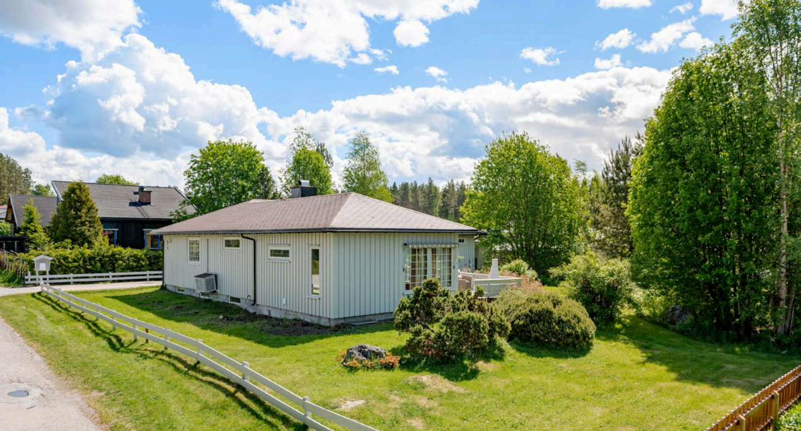
Boligen har stående bordkledning som ble malt sist i ca. 2017 og takteking fra 1983.
