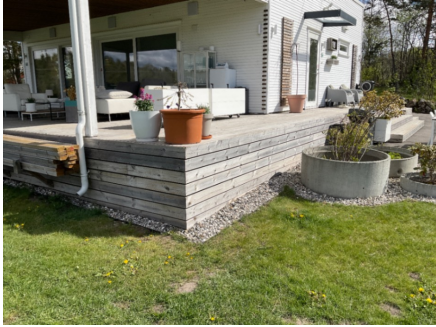
Del av terrasse med manglende rekkverk.
