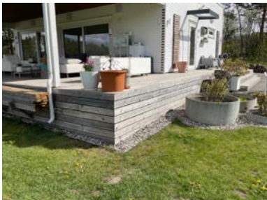
Del av terrasse med manglende rekkverk.
