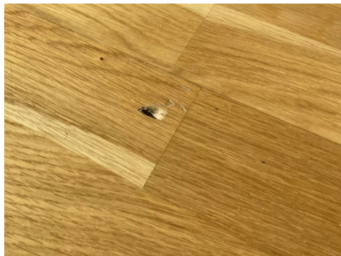
Skade i parkett
