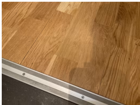
Sprekk i skjøt. Knirk.
