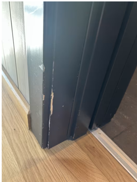
Slitasje på dørkarm.
