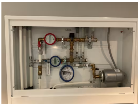
Fordelerskap til vann, plassert i vegg i gang.
