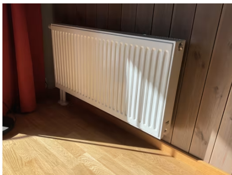
Radiator for vannbåren varme.
