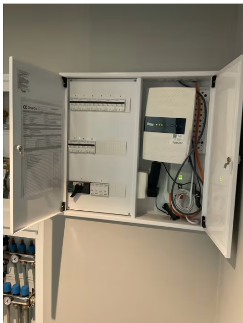
Sikringsskap plassert i gang.
