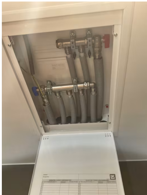
Fordelerskap til vann i tak på badet.
