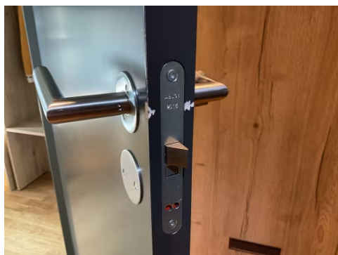
Skade på dør til soverom.
