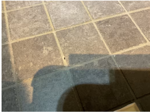
Hull i fugemasse
