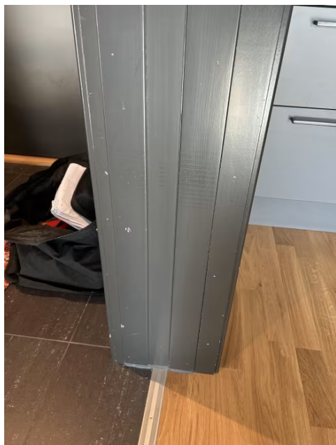
Slitasje på dørkarm.
