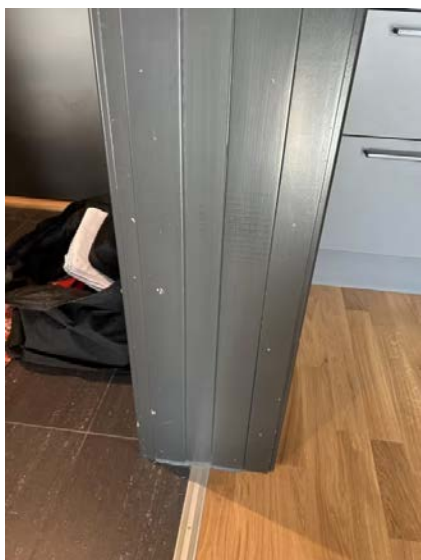
Slitasje på dørkarm.
