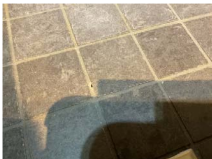
Hull i fugemasse
