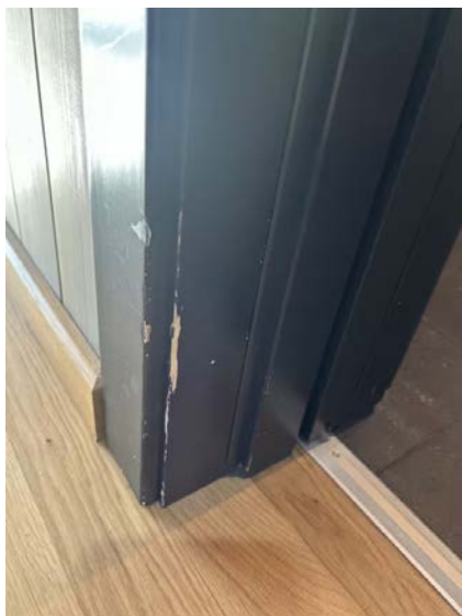
Slitasje på dørkarm.
