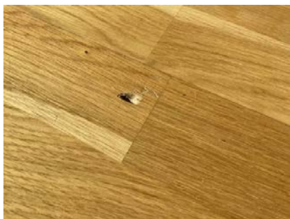
Skade i parkett
