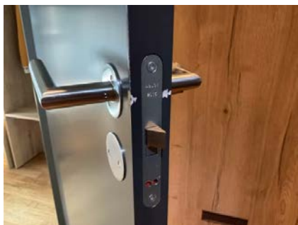
Skade på dør til soverom.
