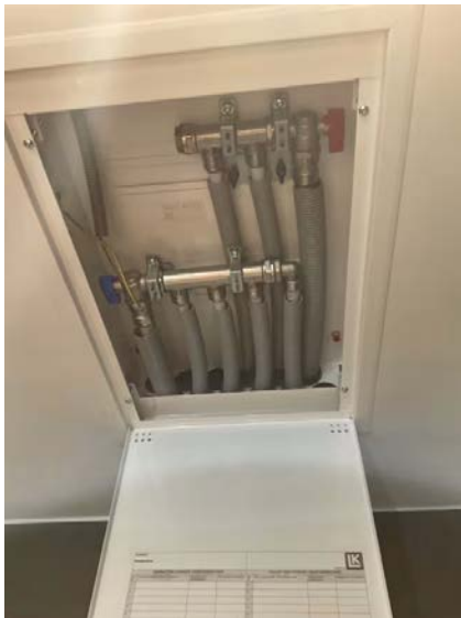
Fordelerskap til vann i tak på badet.
