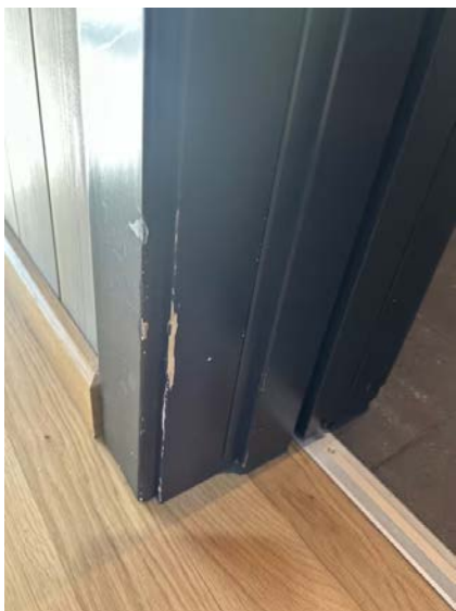
Slitasje på dørkarm.
