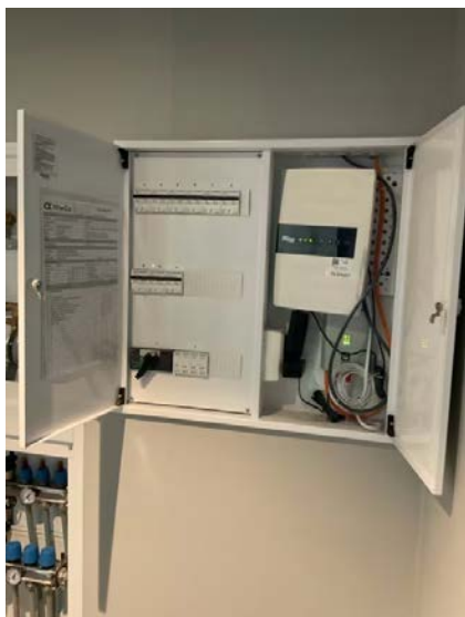
Sikringskap plassert i gang.
