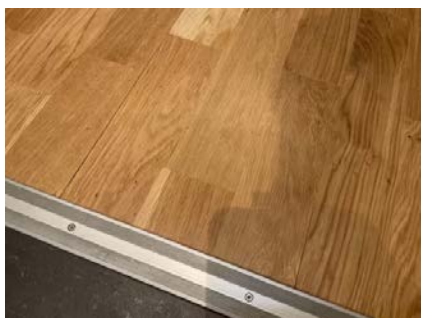
Sprekk i skjøt. Knirk.
