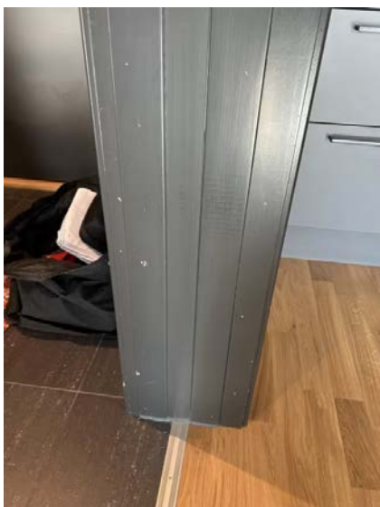
Slitasje på dørkarm.
