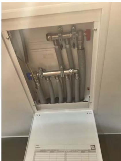
Fordelerskap til vann i tak på badet.
