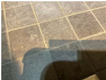
Hull i fugemasse
