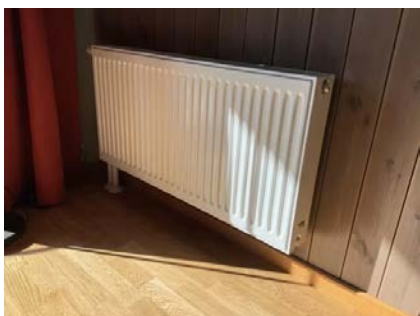
Radiator for vannbåren varme.
