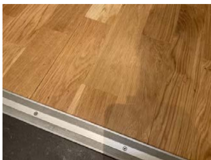
Sprekk i skjøl. Knirk.
