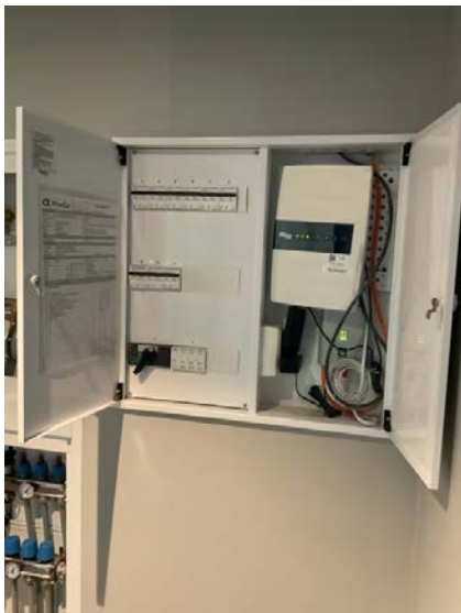
Sikringskap plassert i gang.
