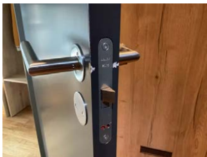
Skade på dør til soverom.
