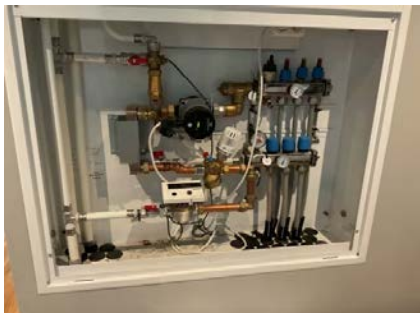
Fordelerskap til vannbårenvarme, plassert i vegg i gang.
