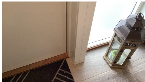
Luftglippe mellom karm og dørblad.
