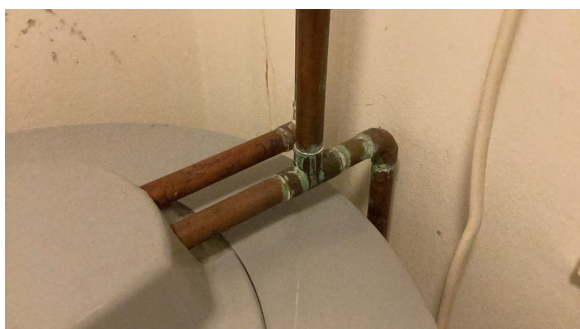
Irr på rør.
