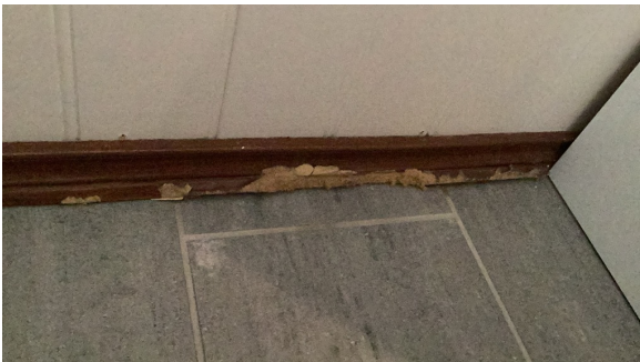
Fotlister med betydelige skader.
