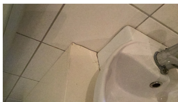
Fuktskader i baderomsinnredning.
