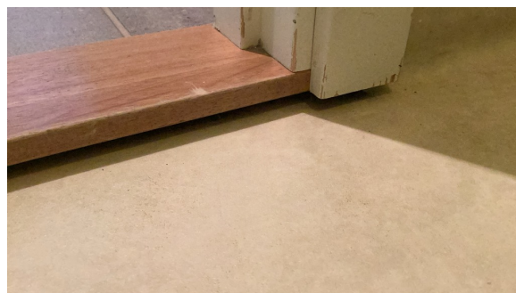
Ingen membran/tetting under terskel.
