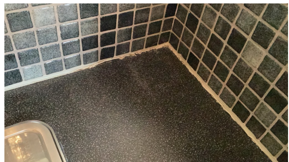
Ujavn silikontetting mellom vegg og benkeplate.
