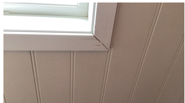
Karmplister på soverom har behov for overflatebehandling.
