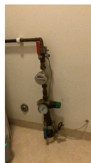
Stoppekran på vaskerom i kjeller.
