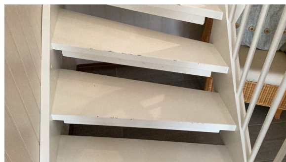
Slitasjemerker i trappetrinn.
