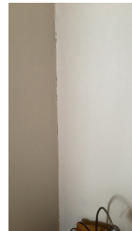
Oppsprekking i hjørner soverom u-etasje.
