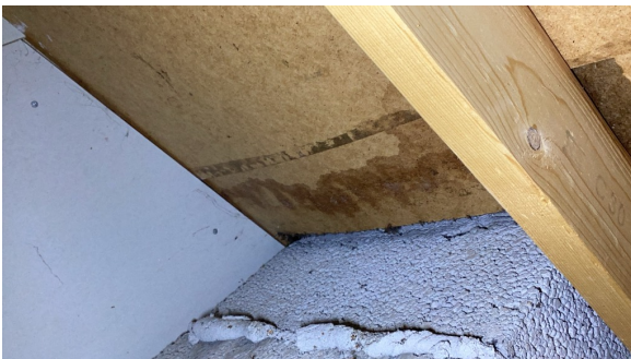
Fuktskjolder ved pipe.
