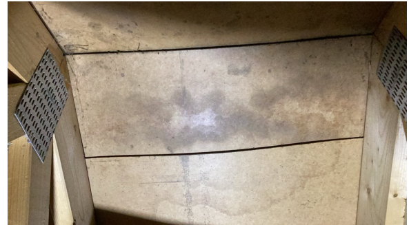
Fuktskjolder i sutakplater ved møne.
