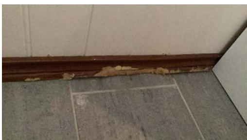
Fotlister med betydelige skader.
