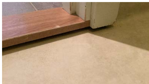
Ingen membran/tetting under terskel.
