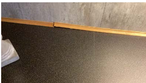
Løs list mellom vegg og benkeplate.
