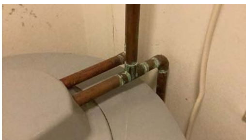
Irr på rør.
