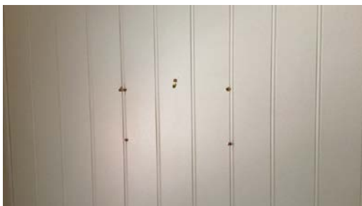
Hull etter oppheng i veggplater
