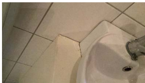
Fuktskader i baderomsinnredning.
