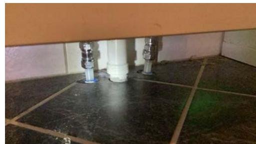
Manglende membran/mansjett rundt rørgjennomføringer.
