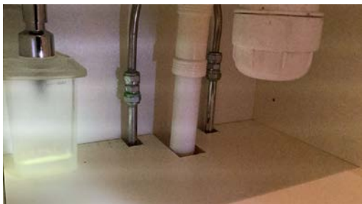
Irr på rør.
