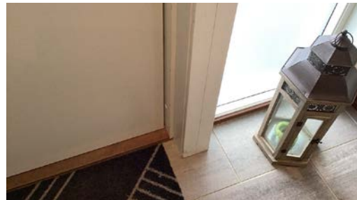
Luftglippe mellom karm og dørbblad.
