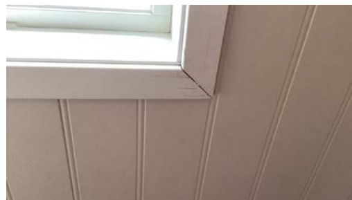
Karmplister på soverom har behov for overflatebehandling.
