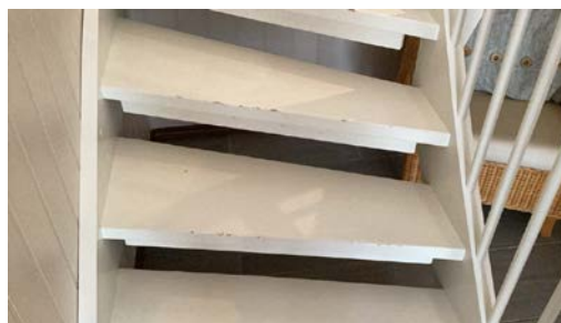
Slitasjemerker i trappetrinn.
