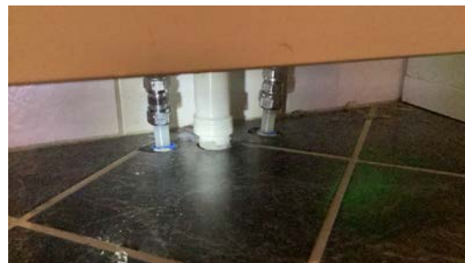
Manglende membran/mansjett rundt rørgjennomføringer.
