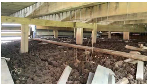
Topplatt mellom mur og grunnmursplaton må utbedres.
