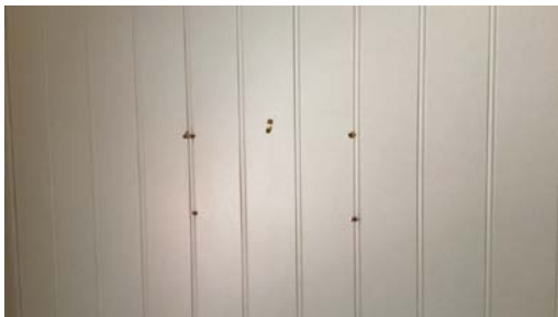
Hull etter oppheng i veggplater
