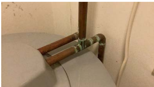
Irr på rør.
