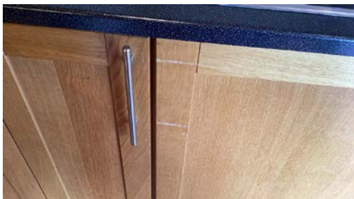
Riper i enkelte skapfronter.
