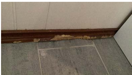
Fotlister med betydelige skader.
