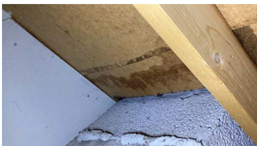
Fuktskjolder ved pipe.
