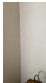
Oppsprekking i hjørner soverom u-etasje.
