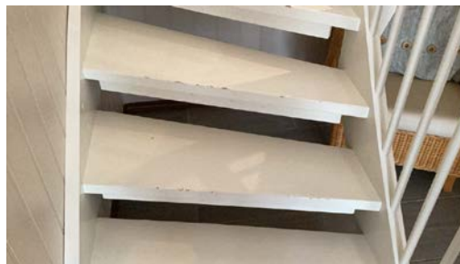
Slitasjemerker i trappetrinn.
