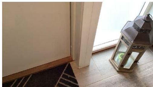
Luftglippe mellom karm og dørbblad.
