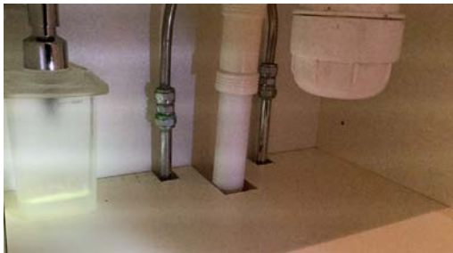
Irr på rør.
