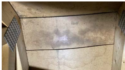
Fuktskjolder i sutakplater ved møne.
