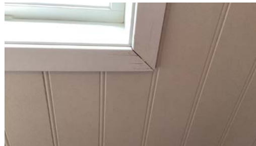
Karmplister på soverom har behov for overflatebehandling.
