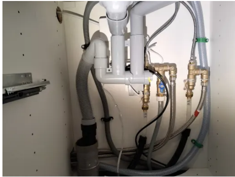
Leiligheten har synlige avløpsrør av plast.
