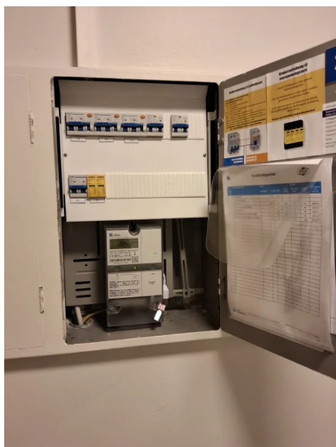
Sikringsskap med automatsikringer er plassert i felles trappeoppgang.
