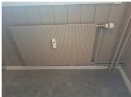
Leiligheten er oppvarmet med radiatorer.
