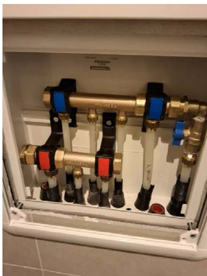
Fordelerskap for rør-i-rør med hovedstoppekran er plassert på bad.
