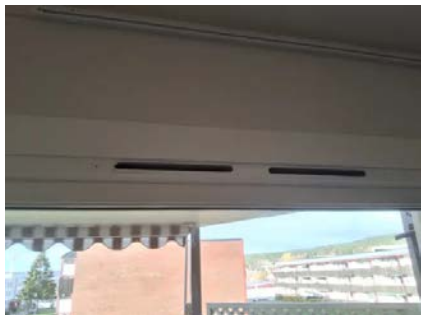
Naturlig ventilasjon med spalter i vinduer.
