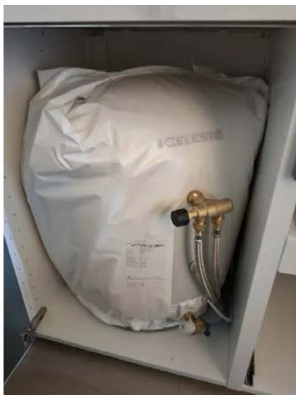
Varmtvannsbereder er plassert i kjøkkeninnredning.
