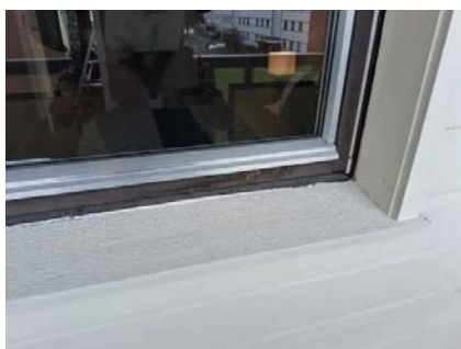
Det ble registrert noe værslitte vinduskarmer.
