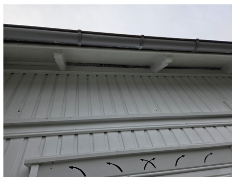
Synlig luftespalte ved raft.
