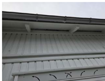
Synlig luftespalte ved raft.
