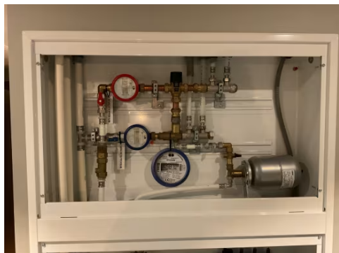
Fordelerskap i gang.
