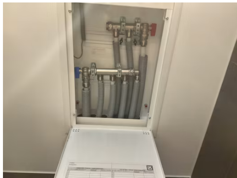
Fordelerskap i taket på bad.
