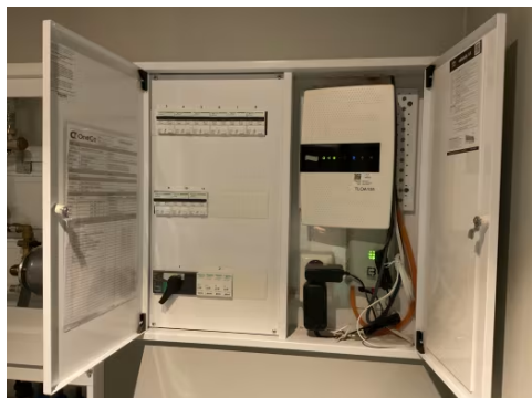
Sikringskap plassert i gang.
