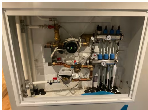
Fordelerskap for vannbårenvarme.
