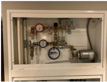
Fordelerskap i gang.
