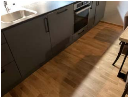
Området for fuktsøk.
