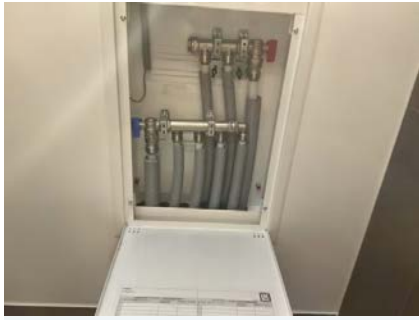
Fordelerskap i taket på bad.
