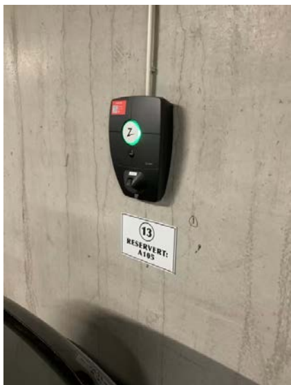
Elbillader på garasjeplass.
