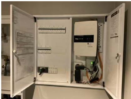
Sikringskap plassert i gang.
