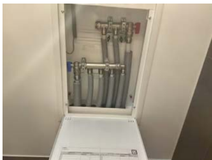
Fordelerskap i taket på bad.
