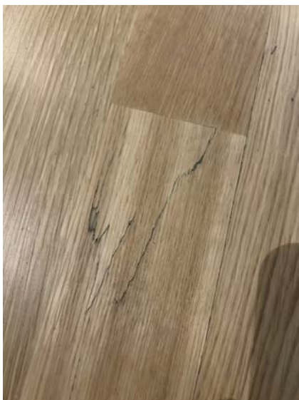
Skade i parkett på stue/kjøkken.
