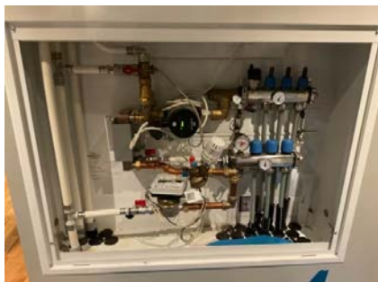
Fordelerskap for vannbårenvarme.
