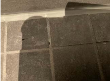
Hull i fugemasse på gulv.
