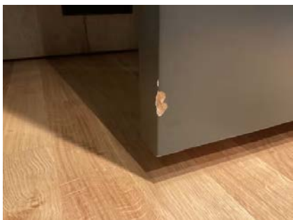
Skade i dørblad.
