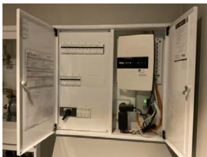
Sikringskap plassert i gang.
