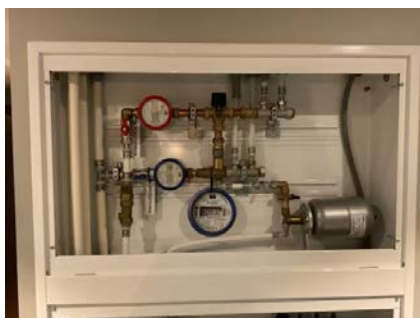
Fordelerskap i gang.
