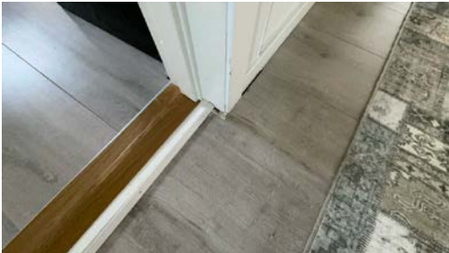
Åpninger og synlig silikon.
