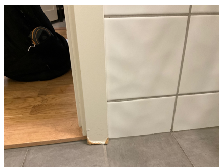
Fuktskader på listverket
