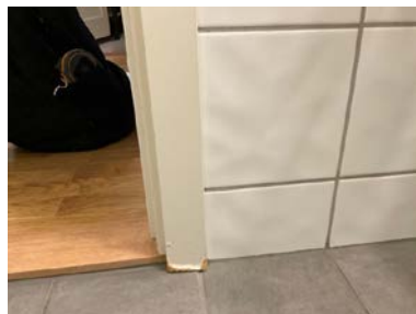
Fuktskader på listverket
