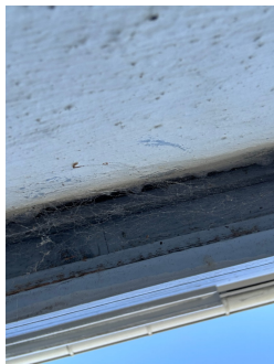
Liten luftespalte mellom kledning og grunnmur ' '
