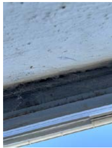
Liten luftespalte mellom kledning og grunnmur !
