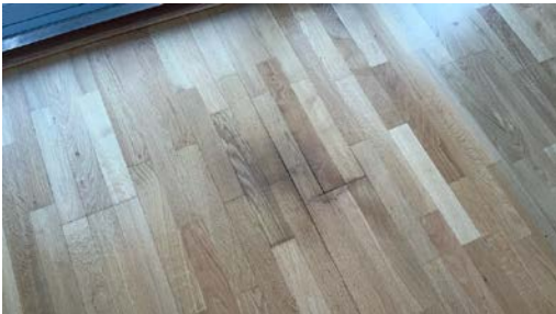
Skade i parkett ved skyvedør.
