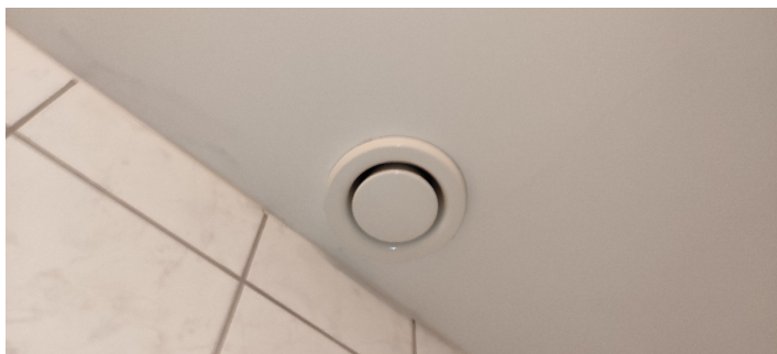
Funksjonstest av avtrekk.
