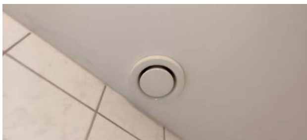
Funksjonstest av avtrekk.
