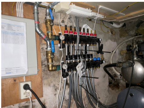
Fordelerstokker for gulvvarme.
