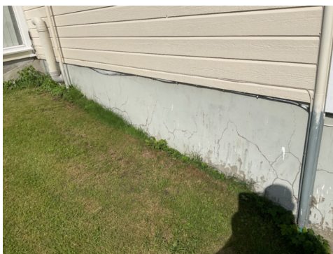
Mindre sprekker i grunnmur.
