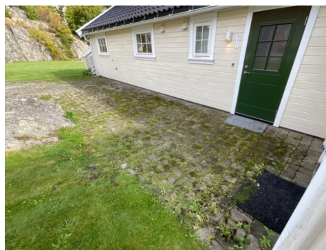
Manglende fall i dette området.
