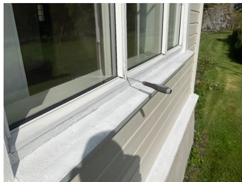
Råteskade i vindu.
