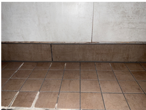
Sprekk og fuktoppsug i plateskjøt.
