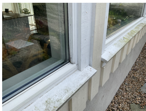
Råteskade i glasslist.
