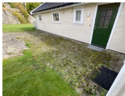
Manglende fall i dette området.
