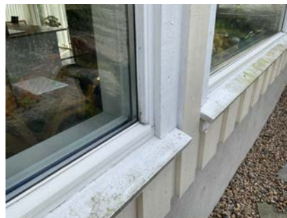
Råteskade i glasslist.
