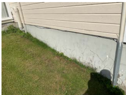
Mindre sprekker i grunnmur.
