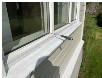
Råteskade i vindu.
