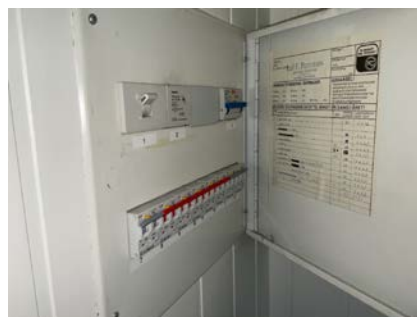
Sikringskap på vaskerom.
