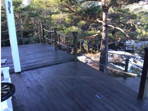
Del av rekkverk som ikke er forskriftsmessig.
