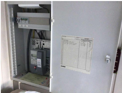
Sikringsskap i bod med fordeling til hytte.
