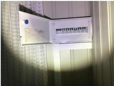
Sikringsskap i hytte.
