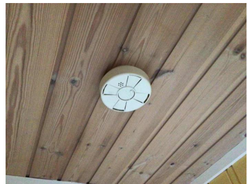
Montert røykvarsler i tak.
