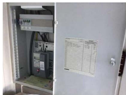
Sikringsskap i bod med fordeling til hytte.
