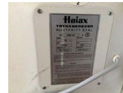
Spekk på varmtvannstank.
