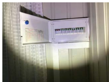
Sikringsskap i hytte.
