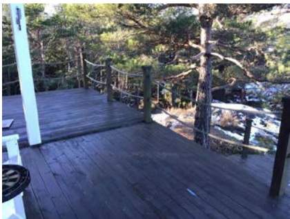
Del av rekkverk som ikke er forskriftsmessig.
