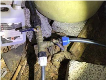
Stoppekran til vann under terrasse.
