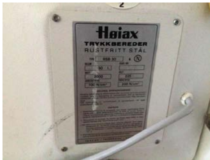
Spekk på varmtvannstank.
