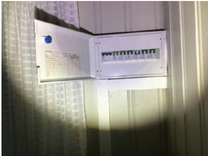
Sikringsskap i hytte.
