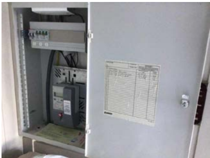
Sikringsskap i bod med fordeling til hytte.
