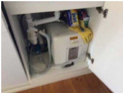
Varmtvannstank i kjøkken benk.
