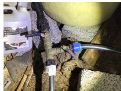
Stoppekran til vann under terrasse.
