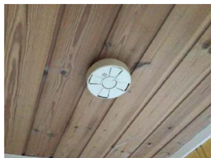
Montert røykvarsler i tak.
