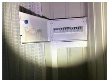
Sikringsskap i hytte.
