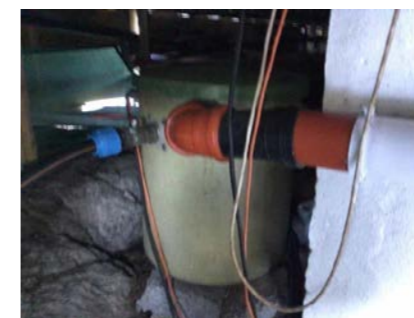
Del av avløpsrør og pumpe kum til kloakk inn på offentlig nett.
