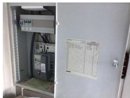
Sikringsskap i bod med fordeling til hytte.
