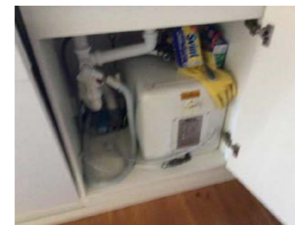
Varmtvannstank i kjøkken benk.
