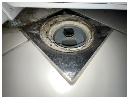
Ingen synlig mansjett i sluken
