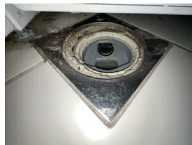
Ingen synlig mansjett i sluken
