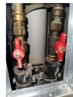
Stoppekraner plassert på bad
