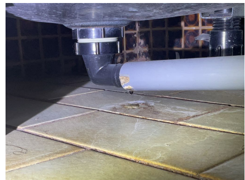
Drypp albue/rørmuffe under kar som er ført til sluk
