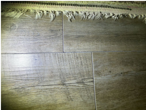
Oppsprekk skjøter vinylplank
