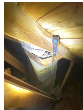
Mindre skjolder ved pipegjennomføring- fuktmåling innenfor "tørt trevirke"
