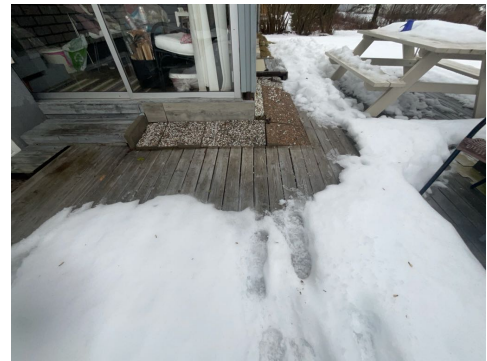
Synlig svanking/ujevnhet i platting
