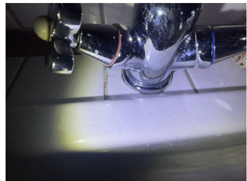
Sprekker i fliser på servantinnredning.
