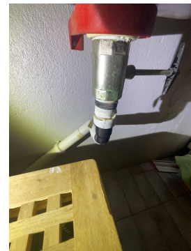
Tapet mot bunnventil på vaskekar
