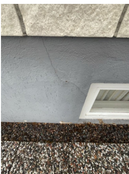
Riss/sprekk i kjelleryttervegg/mur
