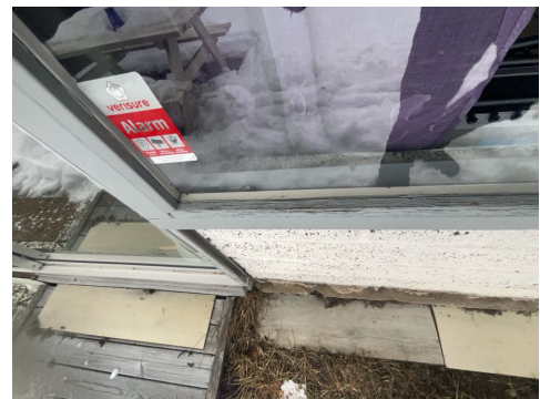
Enkelt innlistede glass (ikke vannbrett/beslag i bunn)
