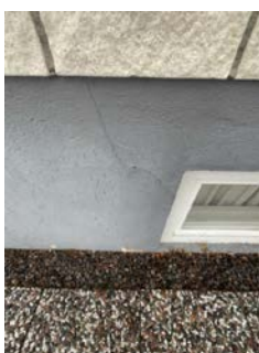
Riss/sprekk i kjelleryttervegg/mur
