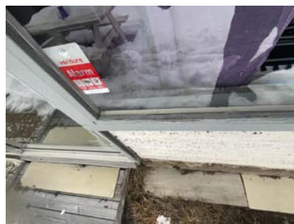
Enkelt innlistede glass (ikke vannbrett/beslag i bunn)
