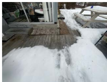
Synlig svanking/ujevnhet i platting
