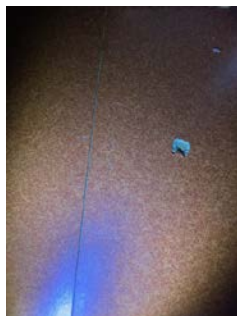
Gammelt belegg oppsprekk skjøt og mindre skade
