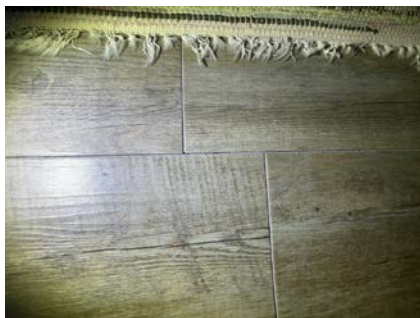
Oppsprekk skjøter vinylplank
