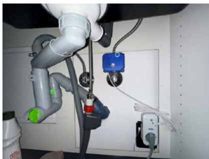
Røropplegg i kjøkkenbenk med Waterguard
