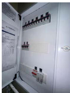
Sikringsskap med automatsikringer.
