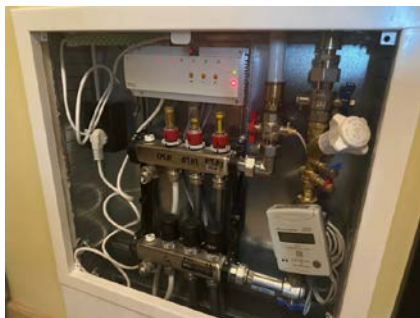
Samleskap for gulvvarme
