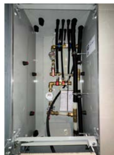
Samleskap med rørkurser og stoppekraner
