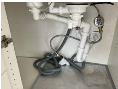
Rør opplegg. Manglende automatisk vannstopper.
