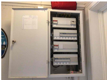
Sikringsskap i felles gang.
