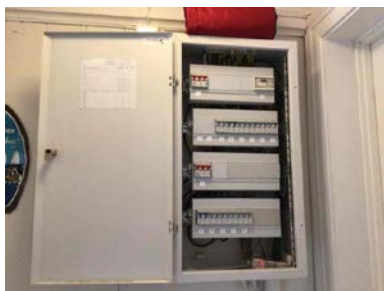
Sikringsskap i felles gang.
