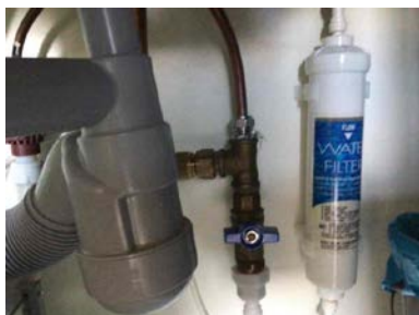
Liten del av etablerte vannrør i leiligheten.
