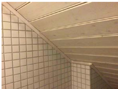
Del av overflate vegg - tak.
