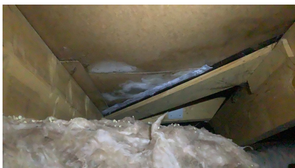
Fuktskjolder i undertak inntil gradrenne.
