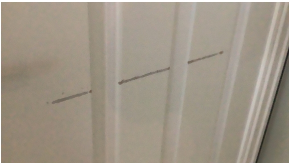
Eksempel på slitasje.
