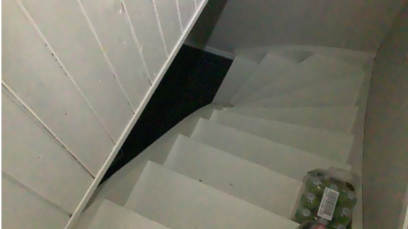
Kjellertrapp mangler rekkverk.
