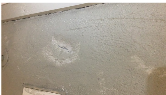
Eksempel på grov utførelse.
