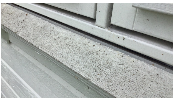
Utett overgang mellom vindu og vannbrett.
