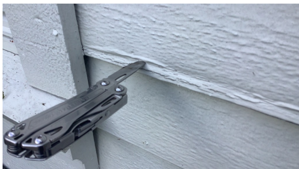
Eksempel på råteskadet kledning.
