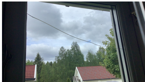
Vindu med sprukket glass.
