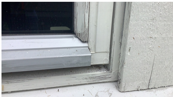
Eksempel på værslitt vindu.
