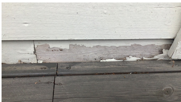
Eksempel på værslitt kledning.
