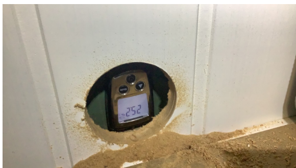
Hulltaking, og det måles skadelig fuktinnhold i treverk.
