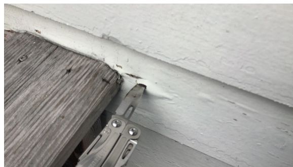
Eksempel på råteskadet kledning.
