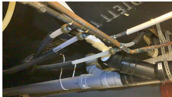
Eventuelt lekkasjevann fra varerør ledes ikke til sluk.
