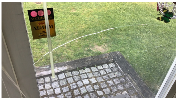
Sprukket glass i balkongdør.
