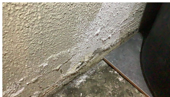
Eksempel på saltutslag på åpen murvegg.
