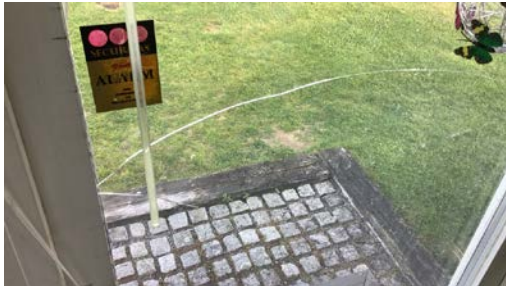
Sprukket glass i balkongdør.
