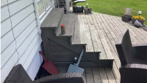
Trapp mangler rekkeverk.
