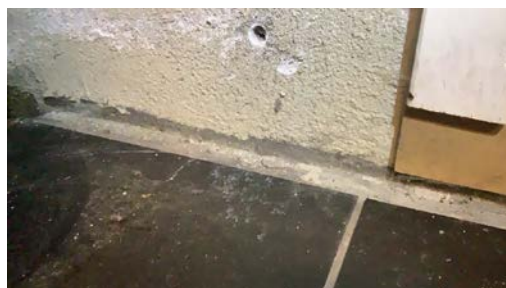
Det er ikke synlig tettesjikt i overgang mellom gulv og vegg.
