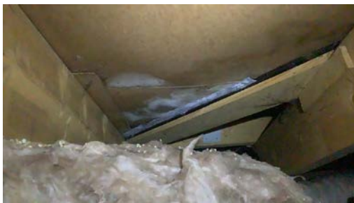
Fuktskjolder i undertak inntil gradrenne.
