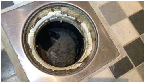
Plastsluk, uten synlig tettesjikt.
