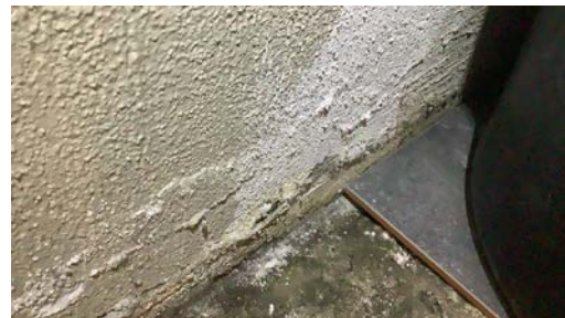
Eksempel på saltutslag på åpen murvegg.
