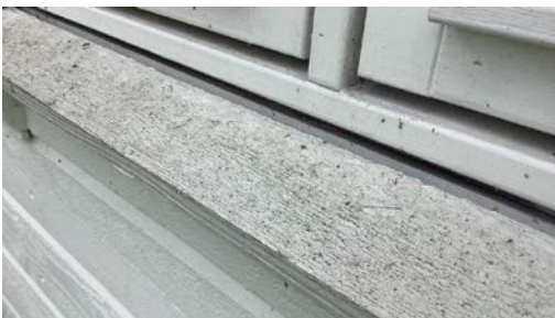
Utett overgang mellom vindu og vannbrett.
