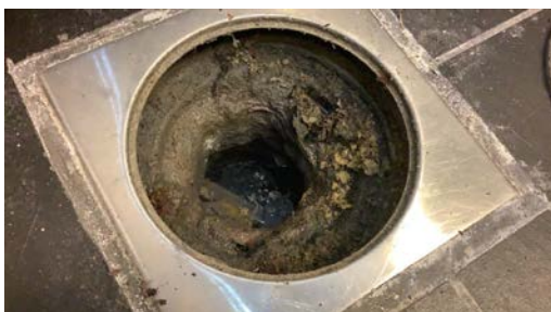
Plastsluk uten synlig tettesjikt.
