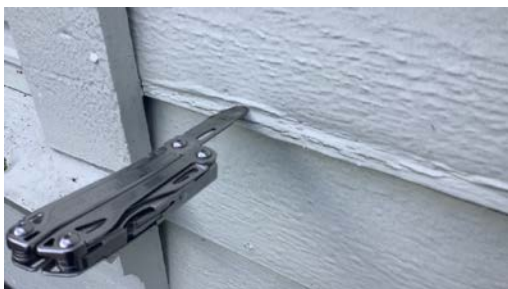
Eksempel på råteskadet kledning.
