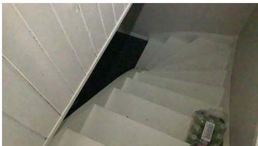
Kjellertrapp mangler rekkverk.
