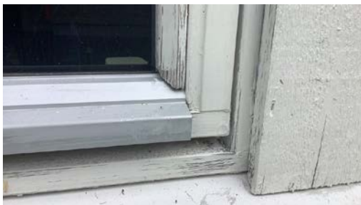
Eksempel på værslitt vindu.
