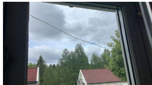
Vindu med sprukket glass.
