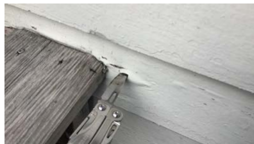
Eksempel på råteskadet kledning.
