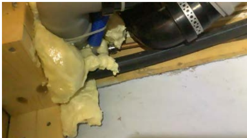
Eventuelt lekkasjevann fra varerør ledes ikke til sluk.
