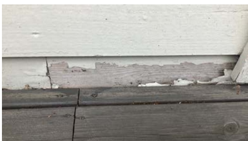
Eksempel på værslitt kledning.
