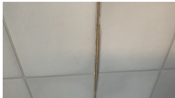
Sprekker i tapetskjøter.
