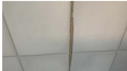
Sprekker i tapetskjøter.
