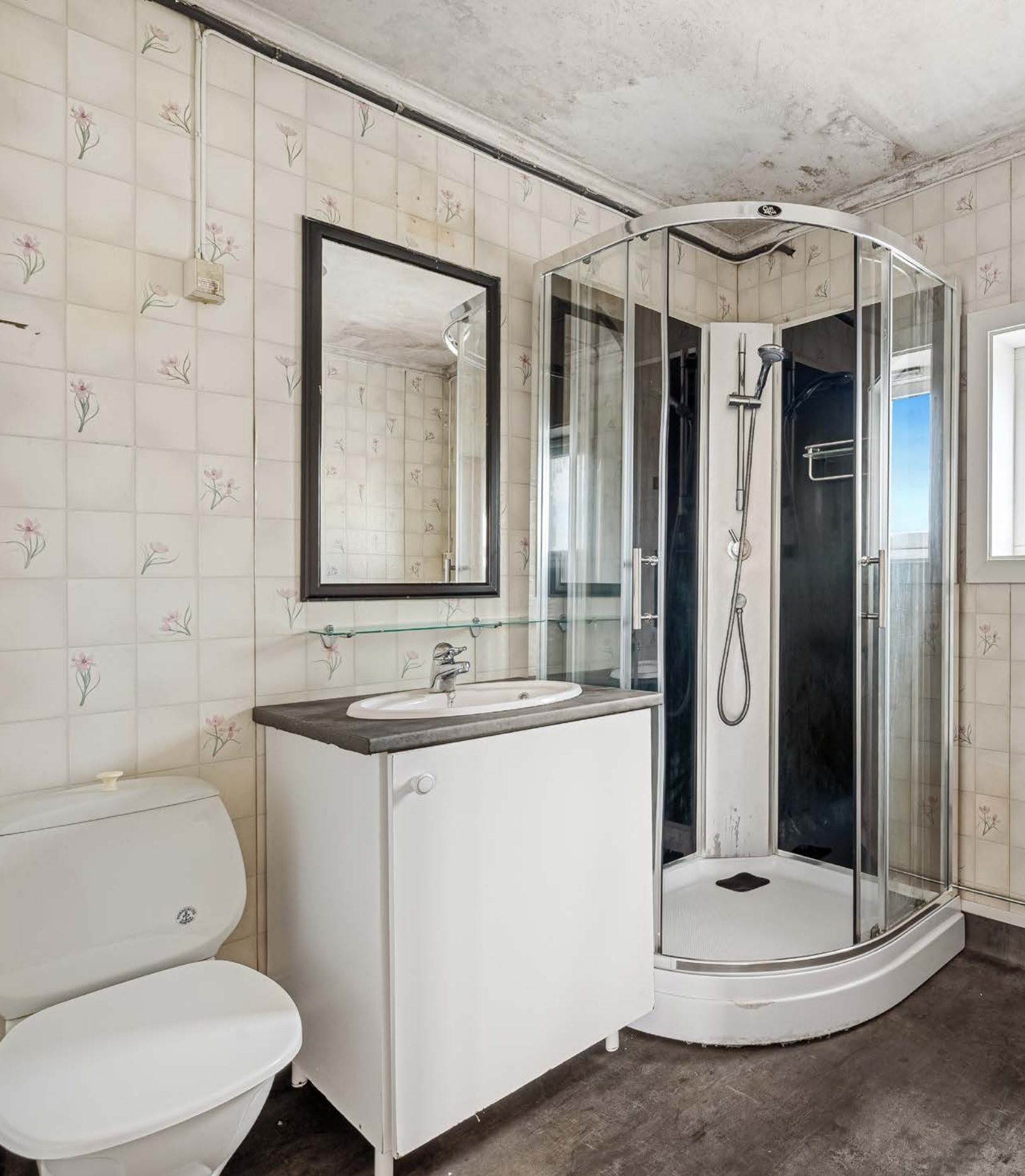
Bad i 2. etg. med wc, dusjkabinett, håndvask med skap.
