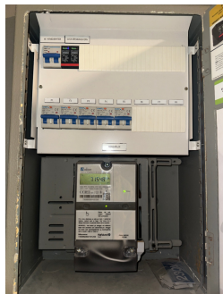
Sikringsskap med automatsikringer.
