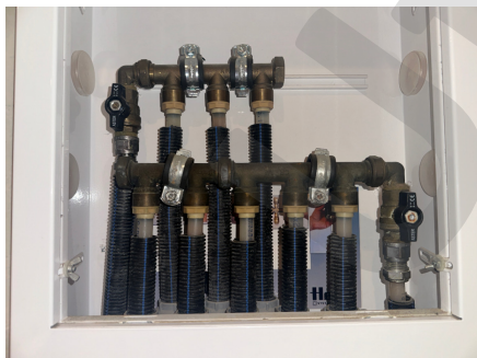
Samleskap med rørkurser og stoppekraner
